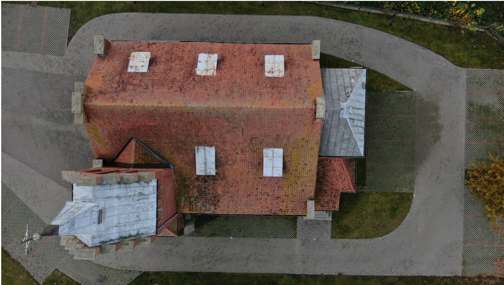
Widok dachów -pokrycie ceramiczne z ubytkami, pokryte mchami, porostami, zielenicami. Pokrycie blaszane z blachy ocynkowanej -zniszczone –przerdzewiałe
